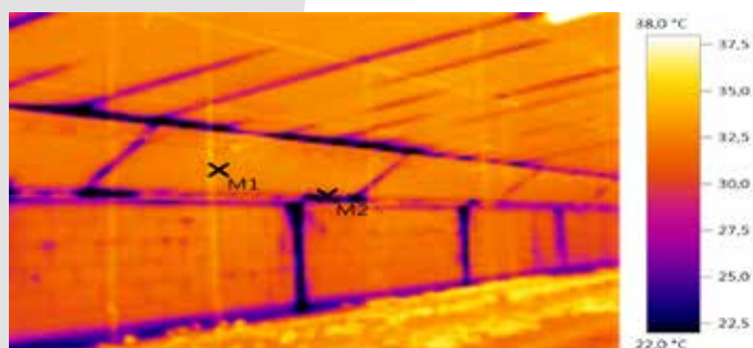
Foto 1: oudere stal met koudebruggen ter hoogte van de inlaatkleppen en de spanten.
